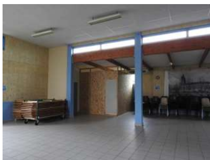
Au foyer : mise aux normes des toilettes pour qu'elles soient accessibles aux personnes handicapées
